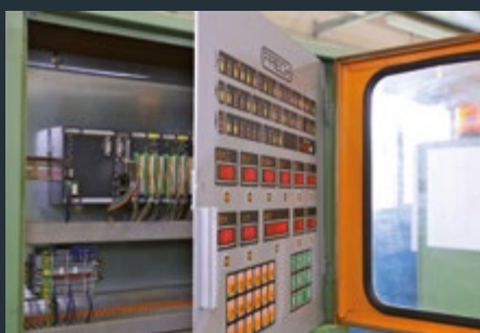
Steuerungsmodernisierung Modernisation of controls
